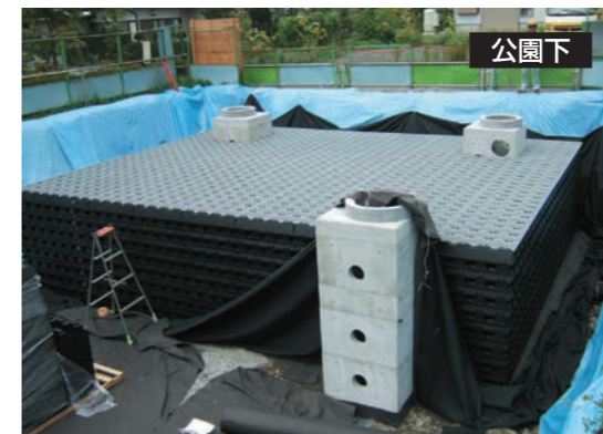
東京都内雨水利用貯水槽 (貯水量: 100m 3 )
