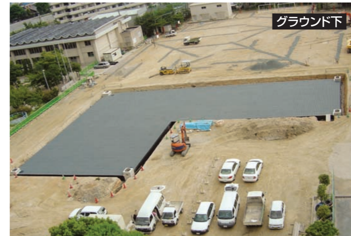
福岡県内小学校調整池 (貯水量: 800m 3 )
