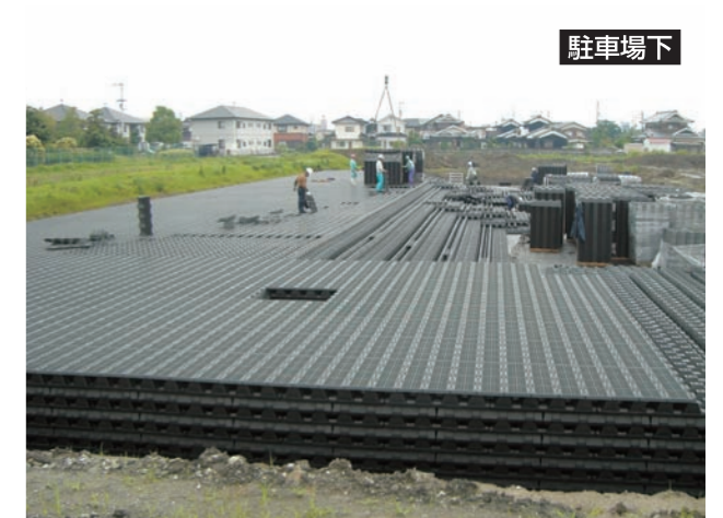
愛媛県内ショッピングセンター調整池 (貯水量: 6,600m 3 )
